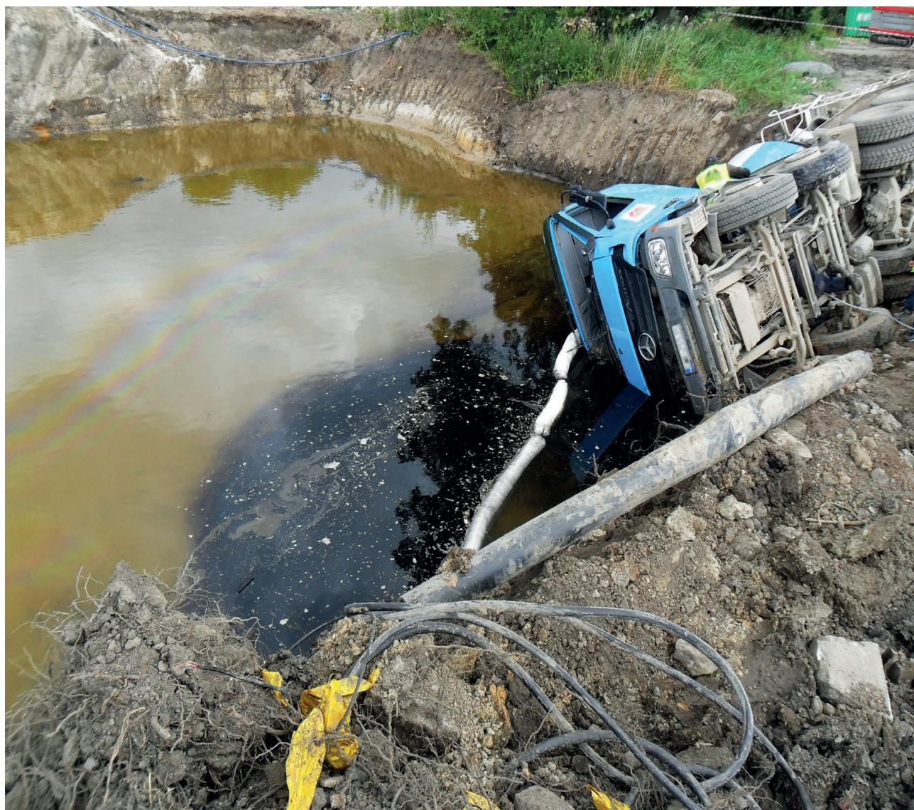
Kontrola WIOŚ Gdańsk po wypadku na terenie placu budowy (fot. arch. WIOŚ Gdańsk)
