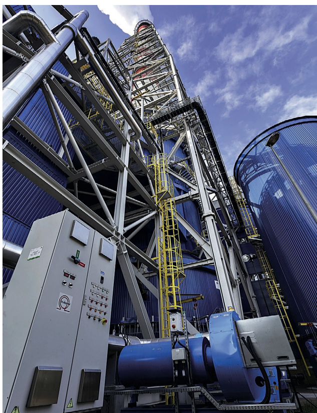
Nowoczesna instalacja odsiarczania spalin metodą mokrą wapienną w Elektrociepłowni Gdańskiej (fot. EDF POLSKA S.A.)
